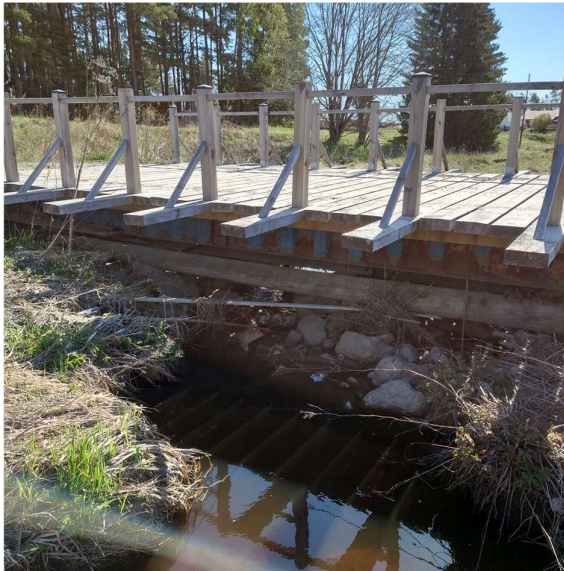
Figur 28. Partiellt vandringshinder bestående av sten under brokonstruktion.
