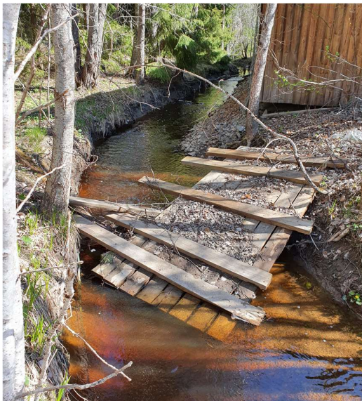
Figur 29. Partiellt vandringshinder bestående av nedfallen spång och ansamling av skräp.
