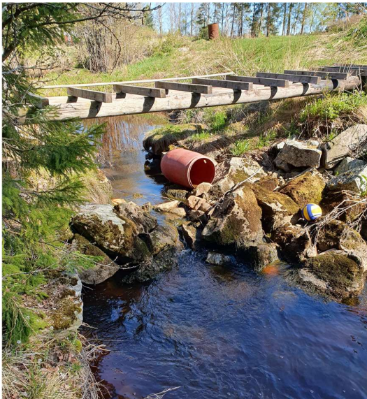
Figur 27. Vandringshinder bestående av äldre raserad stensättning.
