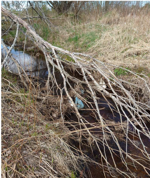
Figur 30. Partiellt vandringshinder bestående av ansamling av skräp.
