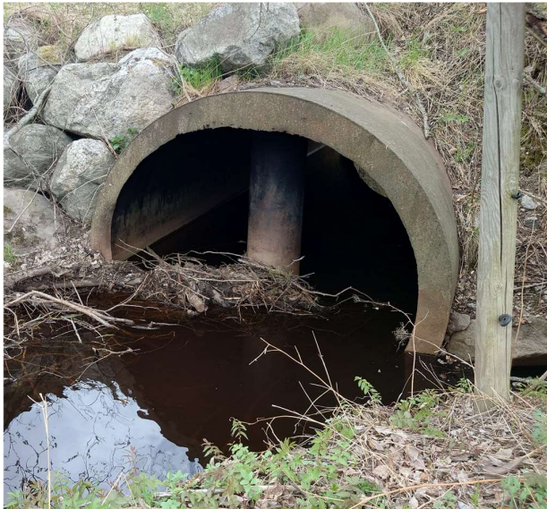
Figur 31. Partiellt vandringshinder bestående av ansamling av skräp.
