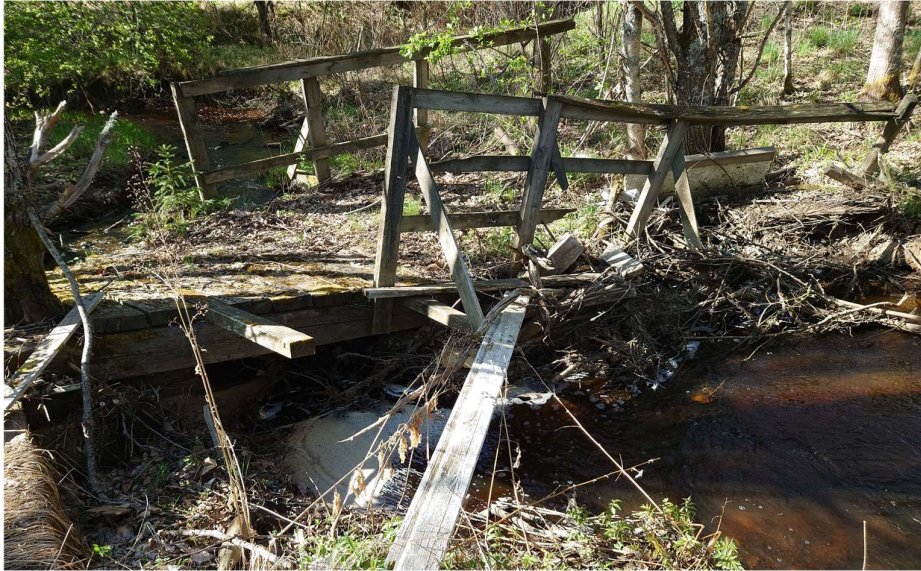
Figur 25. Raserad bro samt skräp som utgör partiellt vandringshinder.
